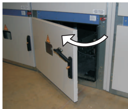
Kabelių skyriaus durelių atidarymas
