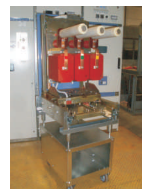
Įtampos transformatorius ant ištraukiamo vėžimėlio
