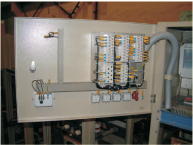
Relinių apsaugų ir automatikos skyriaus durelės
