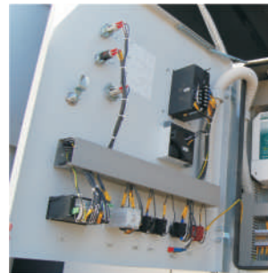
Relinių apsaugų ir automatikos skyriaus durelės
